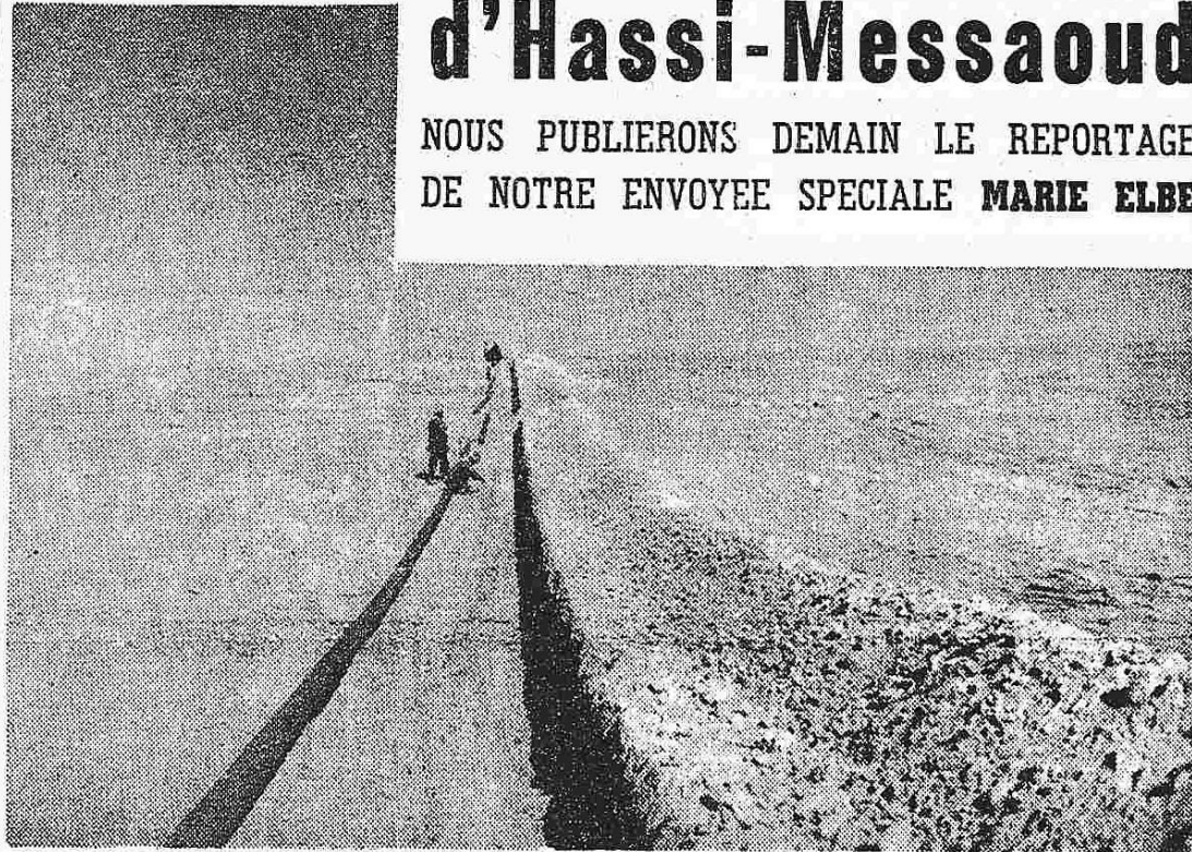
Hassi-Messaoud-Touggourt à quelque temps du Jour J où le pétrole empruntera le pipe
